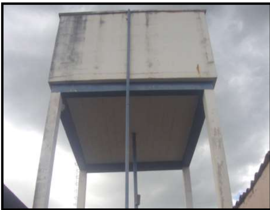
Figura 8 - Reservatório do sistema 1
