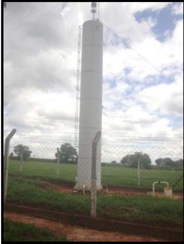
Figura 11 - Reservatório do sistema 4
