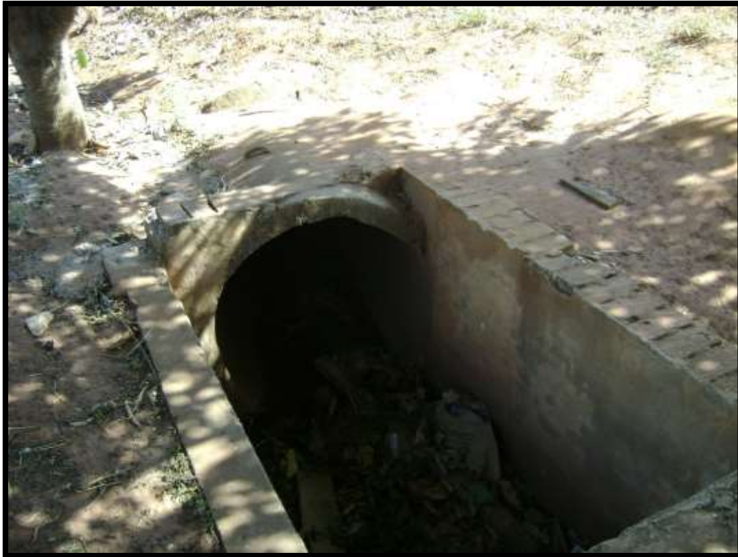
Figura 35 - Caixa de junção existente
