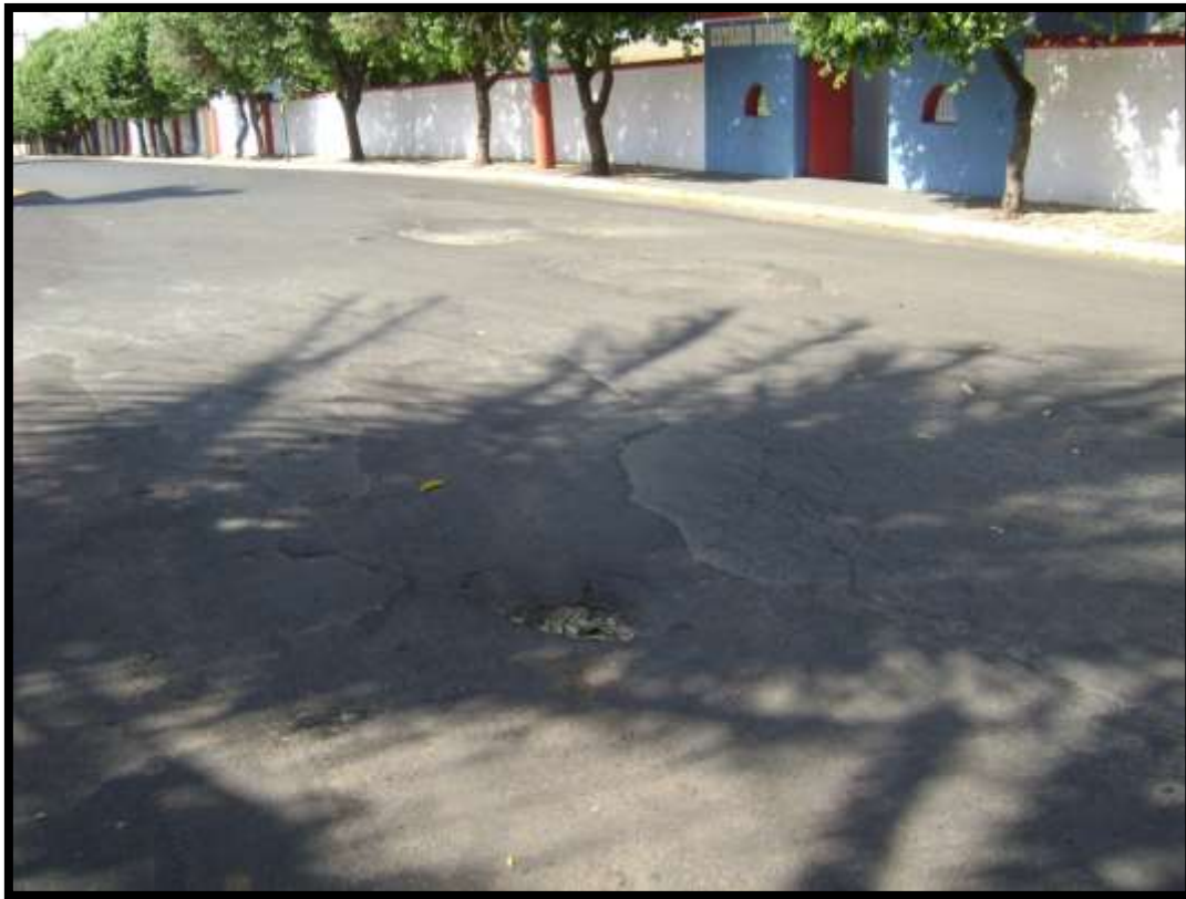
Figura 31 - Vista da Rua 7 de Setembro, mostrando o afundamento do pavimento
